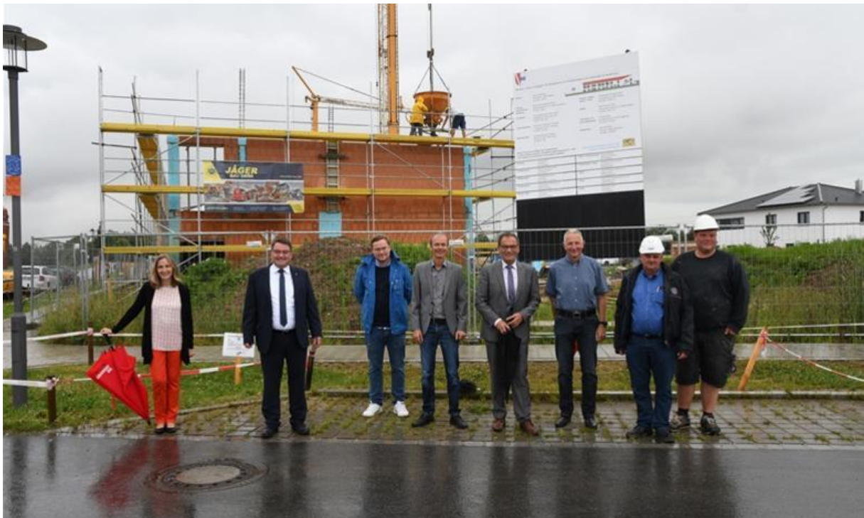
Sylvia Meyer und Martin Steinkirchner (Johanniter), Ludwig Lieb und Roland Weigl (beide EBB), Bürgermeister Hans Thiel, Baureferatsleiter, Baumgartner und Polier Florian Niebauer sowie Otto Jäger (Baufirma Jäger; von links) besichtigten die Baustelle des Kindergartens. Foto: Tino Lex
