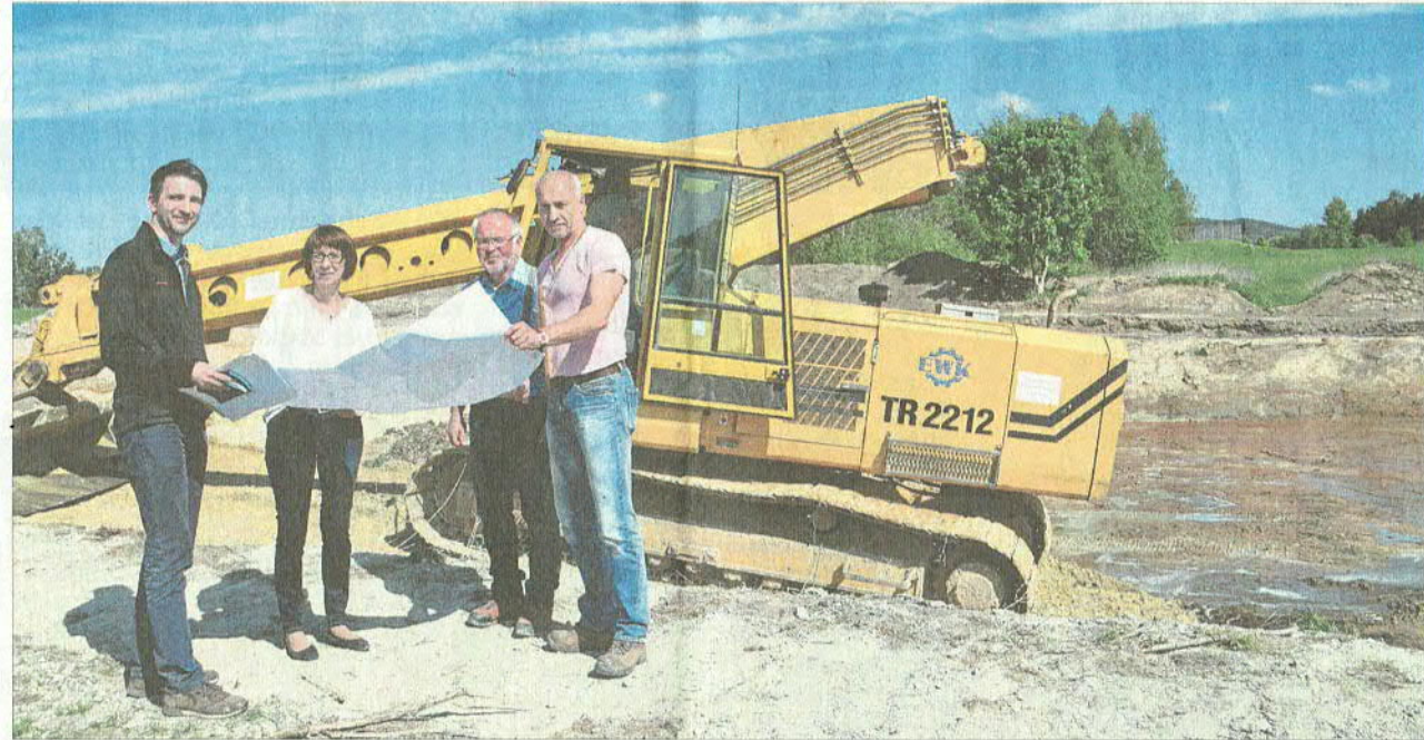
Bauamtschef Christian Meier, Bürgermeisterin Margit Kirzinger, Michael Baumer senior und Peter Fuchs (von links) vom Ingenieurbüro EBB freuen sich über den Start der Bauarbeiten am Regenrückhaltebecken. Bild: fjo
