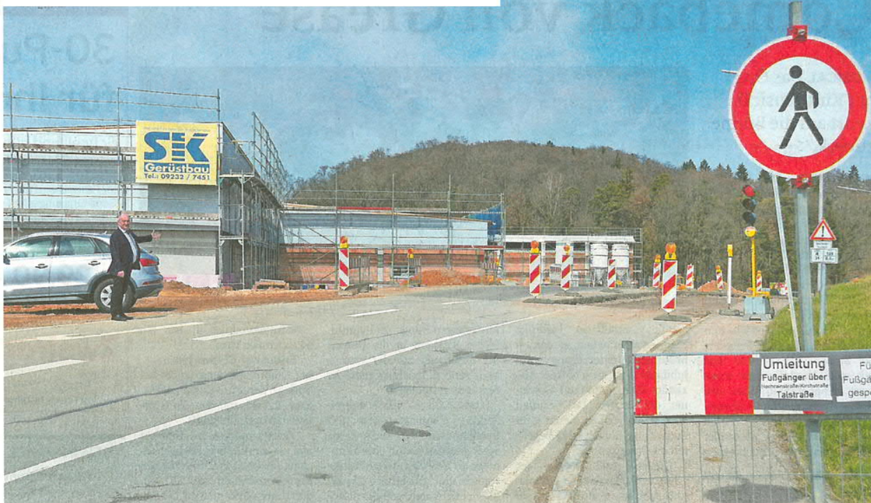
Am westlichen Ortsrand von Alt-Nittendorf entstehen neben dem Kreisverkehr auch zwei neue Lebensmittelmärkte.
