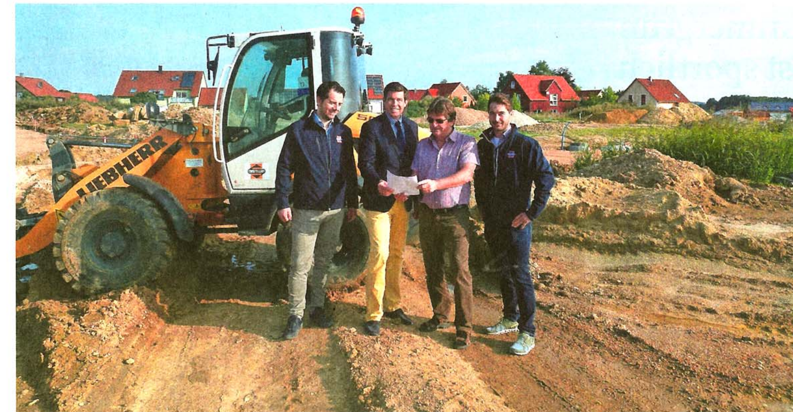
Jour Fix vor Beginn der Straßenbauarbeiten: im Bild (von links) Christian Karl (Firma Swietelsky), Bürgermeister Patrick Grossmann, Matthias Schiedrich (EBB) und Matthias Anetsberger (Swietelsky)
