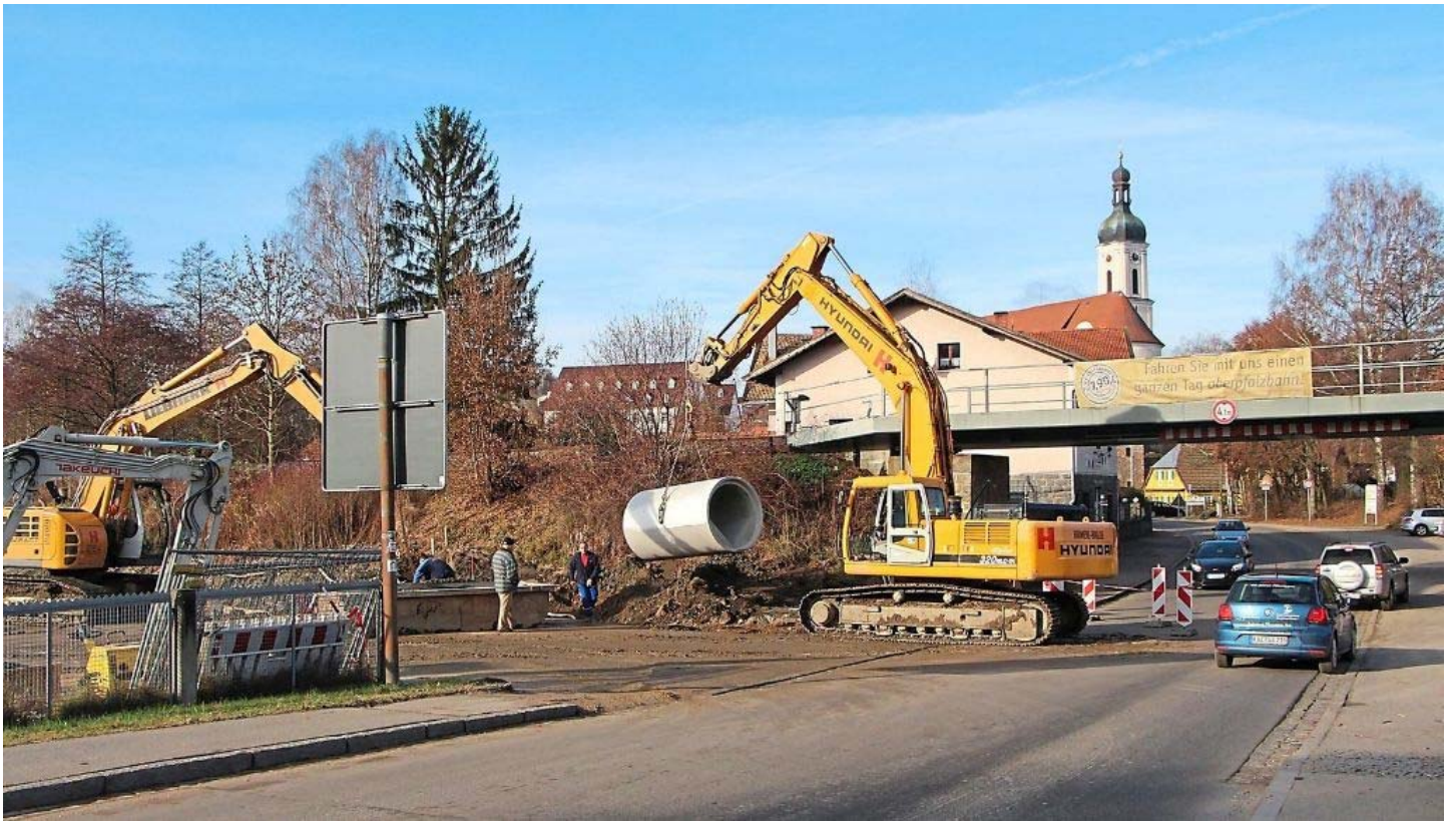
Ab Montag ist die Ludwigstraße gesperrt. Es dauert zwei bis vier Wochen, bis die Kanalarbeiten in diesem Bereich abgeschlossen sind. Foto: Zitzelsberger
