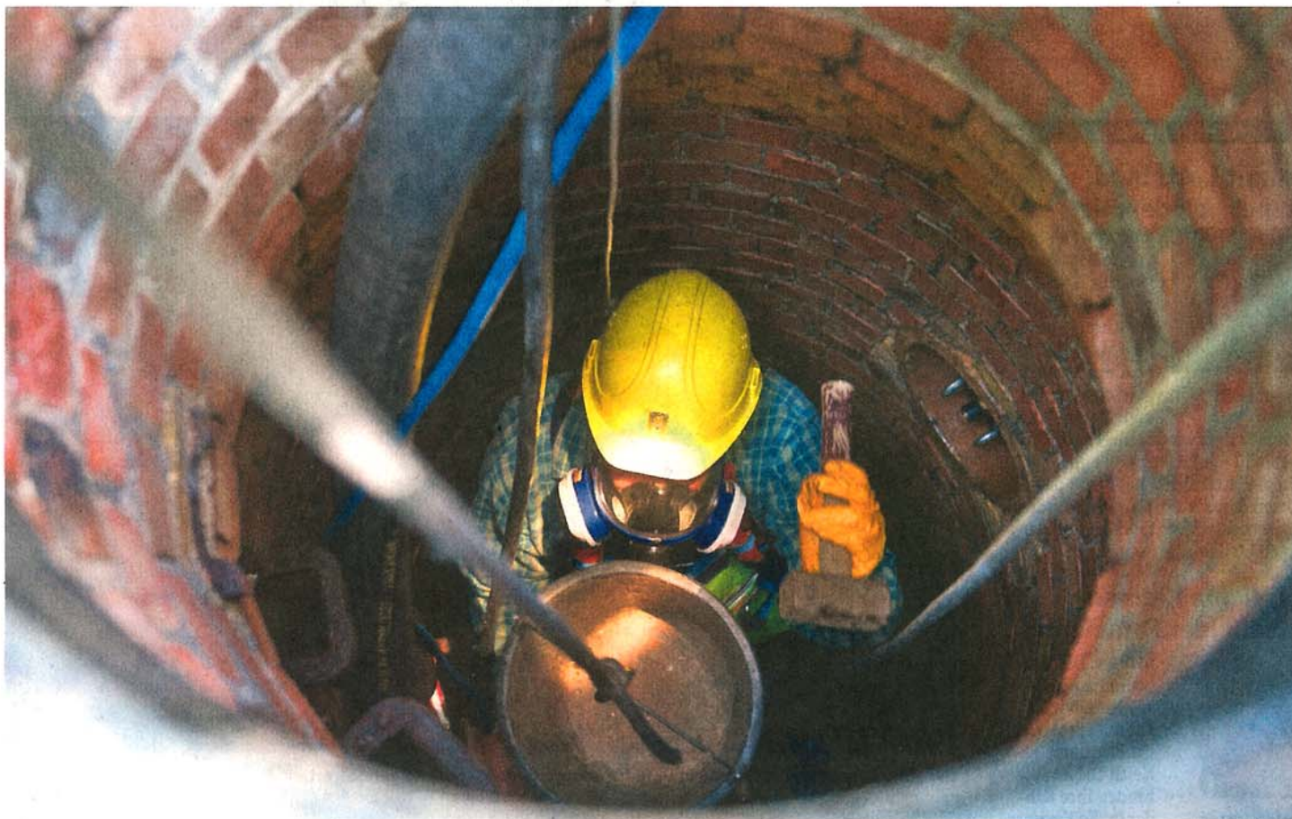
Bei der Überprüfung des Abwasserkanals in Laaber wurden erhebliche Mängel festgestellt.
