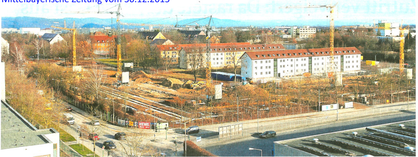
Die weitläufige Baustelle an der Ecke Bajuwaren-/Benzstraße wird markiert von fünf Baukränen.
