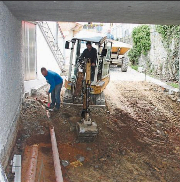
An der Fußgängerunterführung der Regenstraße entsteht derzeit das Fundament für die Fluttore.
