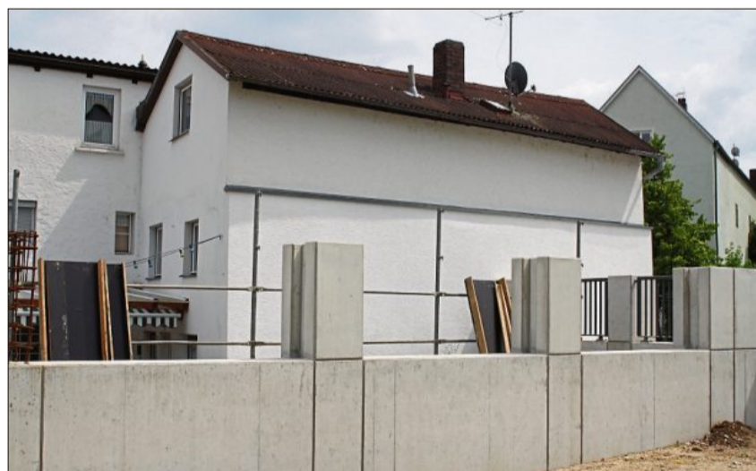
Beim Altstadtcafé wird die Schutzmauer im Bedarfsfall mit mobilen Elementen dicht gemacht.
