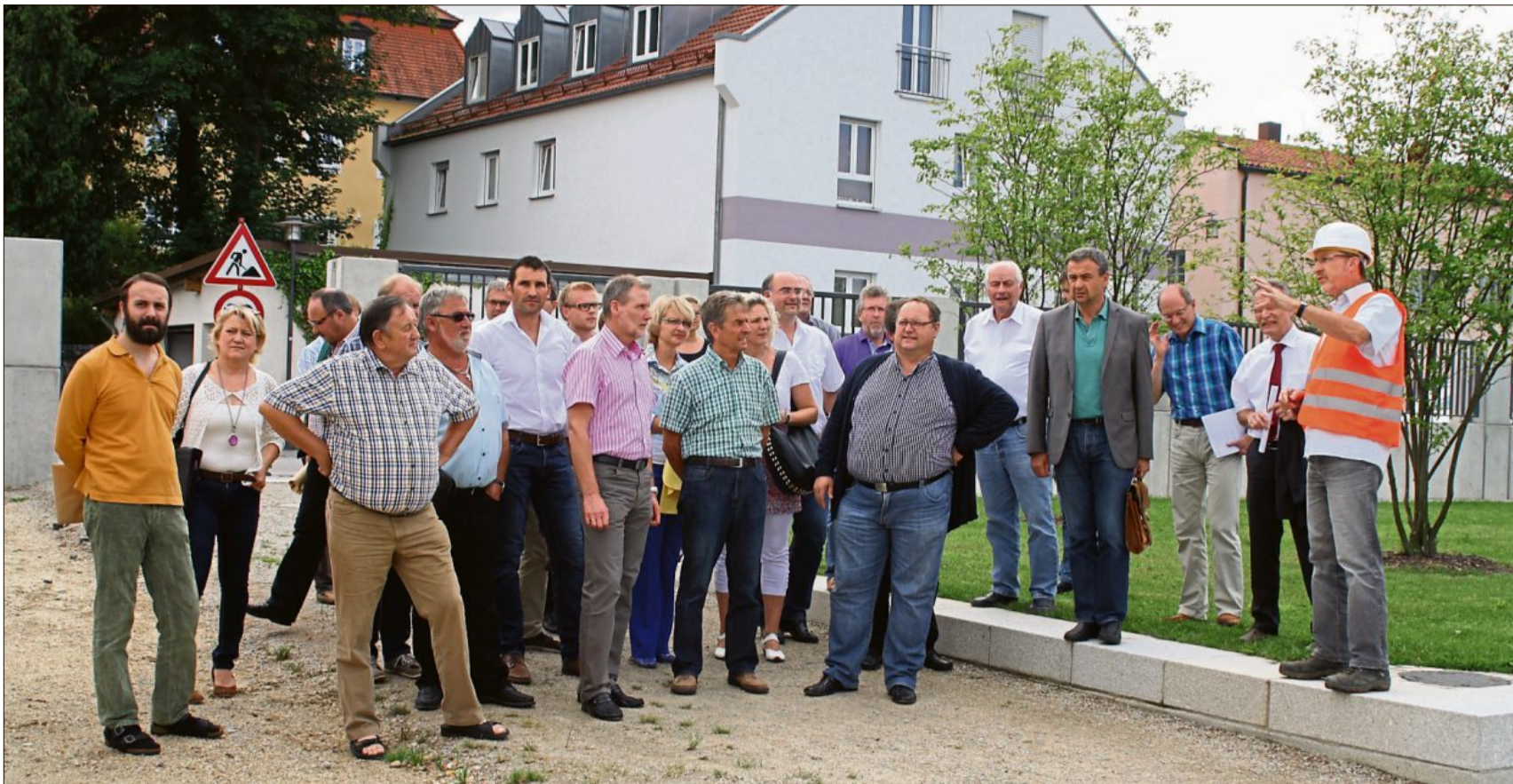
Ortstermin am Esper: Bauoberrat Alfons Lerch (rechts) führt die Räte über die Baustelle für den Rödinger Hochwasserschutz am Esper.
