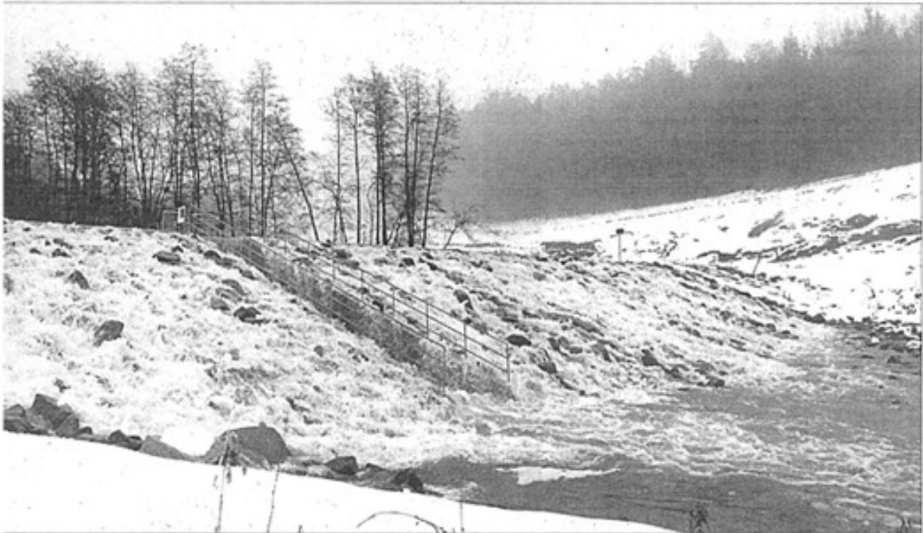
Von den Wassermassen überspült wurde der 2008 eingeweihte Rückhaltedamm am Erlachbach beim jüngsten Hochwasser. Dennoch sind die Verantwortlichen von seinem Schutz überzeugt, fordern aber noch weitere Maßnahmen. – Foto: fr
