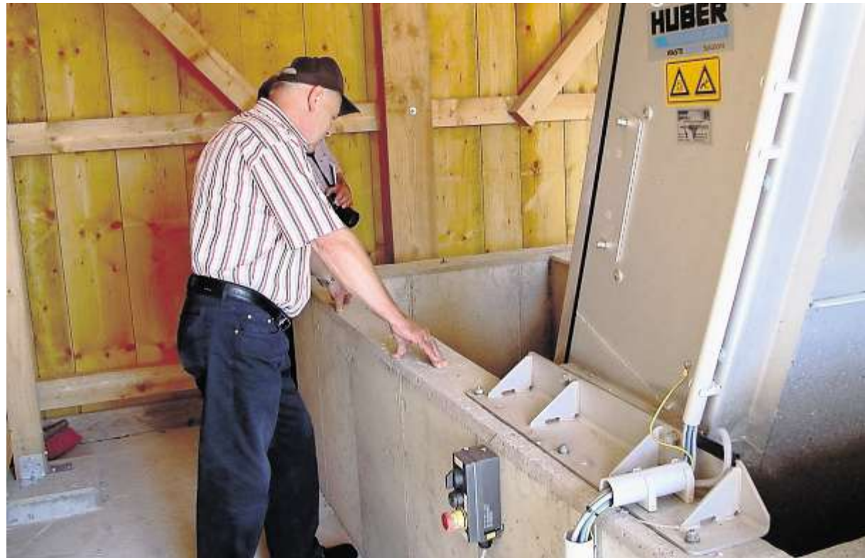
Klärwärter Johann Schustereder zeigt den neuen Rechen, für den 70 000 Euro ausgegeben wurden. Foto: Thomann
