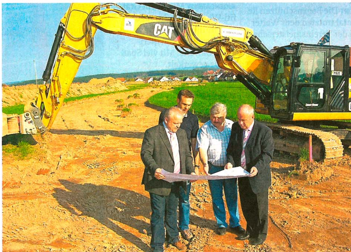
Die beiden Bürgermeister Siegfried Böhringer (rechts) und Johann Dechant (links) sowie der Vorsitzende des Zweckverbandes zur Abwasserbeseitigung, Fritz Dechant, und Ingenieur Christian Kotschate besichtigten die Straßenbaustelle im neuen Baugebiet „An der Hohenwarther Straße“ in Steinsberg. Foto: Merl
